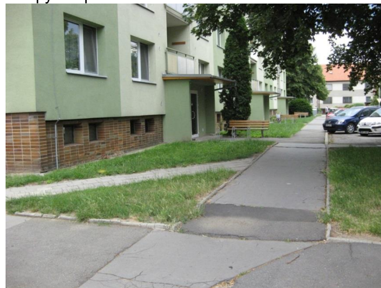
havarijný stav asfaltových chodníků
