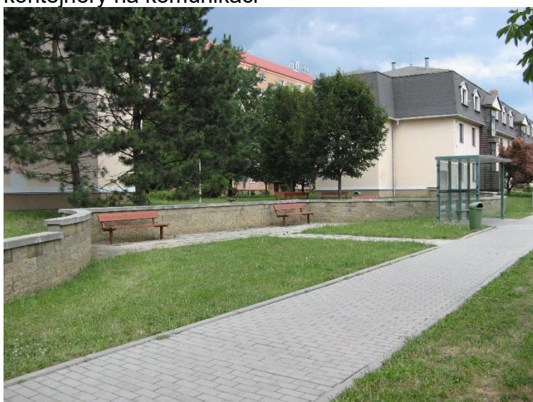
nefunkční zídky u zastávky MHD na ul. Brněnská
